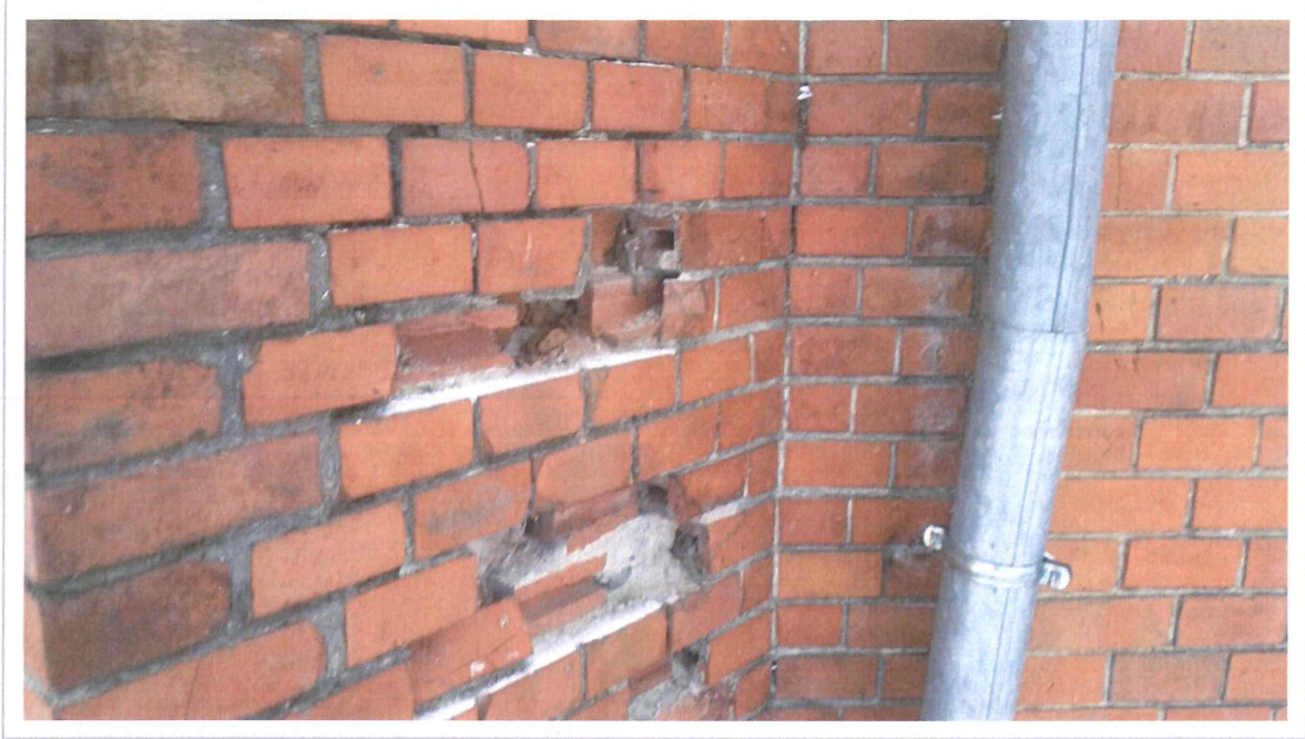
Fotografia 3. Uszkodzenia lica ceglanego
