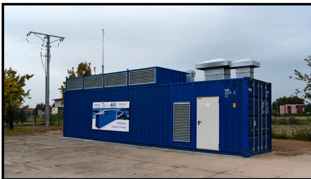
Zdjęcie 9 Przykład magazynu energii
