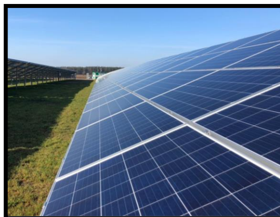
Zdjęcie 2 Polikrystaliczne panele fotowoltaiczne
