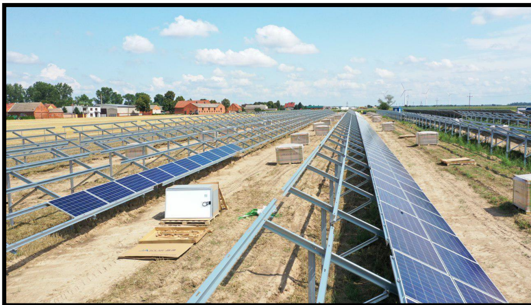
Zdjęcie 6 Konstrukcja wsporcza (farma słoneczna Ziemiń, gm. Krobica)
